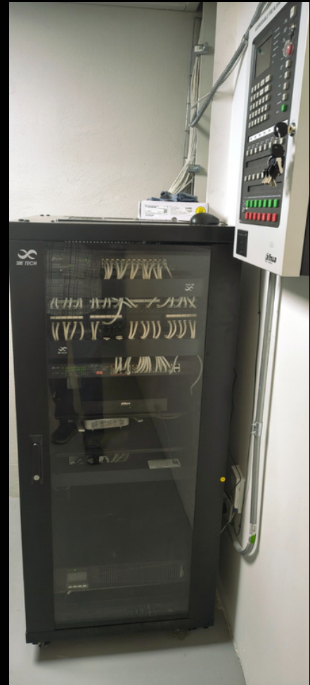
Site de Telecomunicaciones (MDF / IDF)
