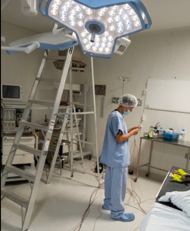
Instalación eléctrica aislada en quirófano
