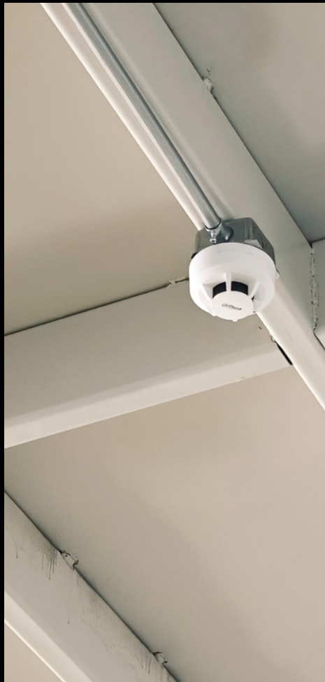
Detección de incendios
