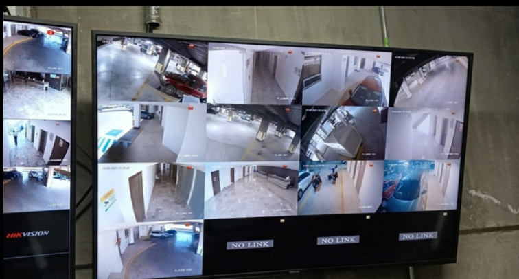
Centros de comando y control
