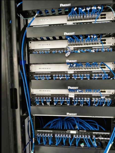
Rack de Telecomunicaciones
